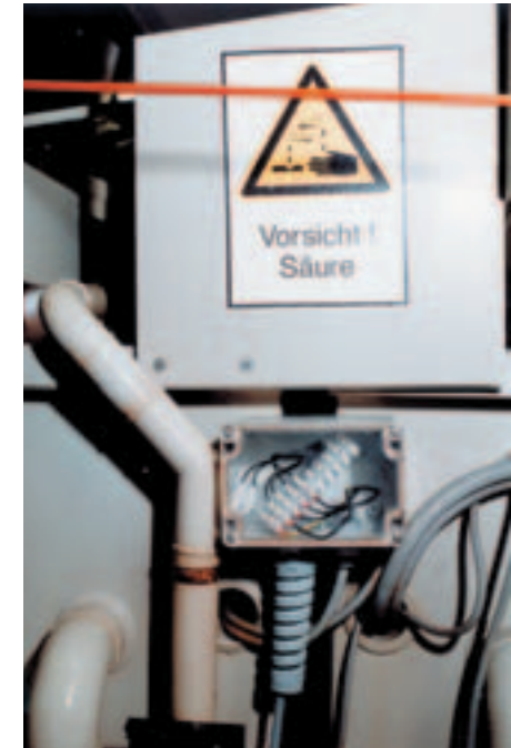
Bild 5-1: Die Elektroausstattung in der erforderlichen IP-Schutzart. Die Verwendung derartiger Klemmen ist zwar weit verbreitet, entspricht jedoch nicht der hier anzuwendenden DIN EN 60 204-1 (Elektrische Ausrüstung von Maschinen)
