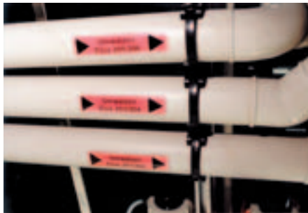
Bild 3-4: Kennzeichnung von Rohrleitungen
