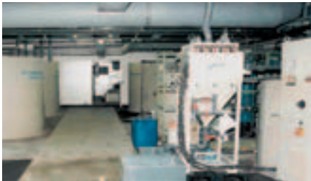
Bild 6-1: Die Abwasserbehandlung ist wesentlicher Bestandteil einer gut funktionierenden Galvanik. Mit ihr wird auch Geld gespart
