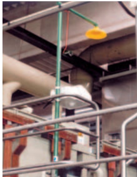
Bild 9-1: Augendusche und Dusche am Zugang zum Wartungsgang
