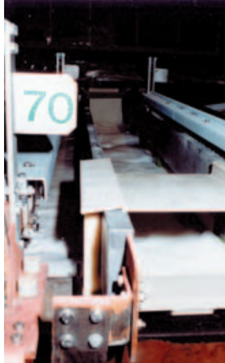
Bild 3-8: Bäder mit Gasentwicklung müssen abgedeckt oder abgesaugt werden
