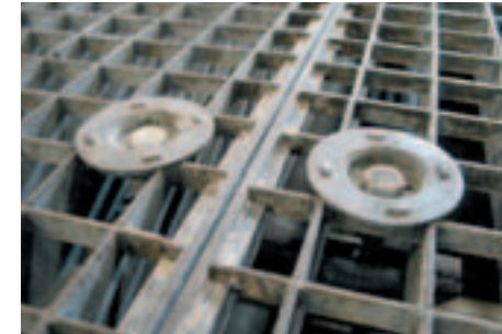
Bild 3-3: Sicher befestigte Bodenroste
