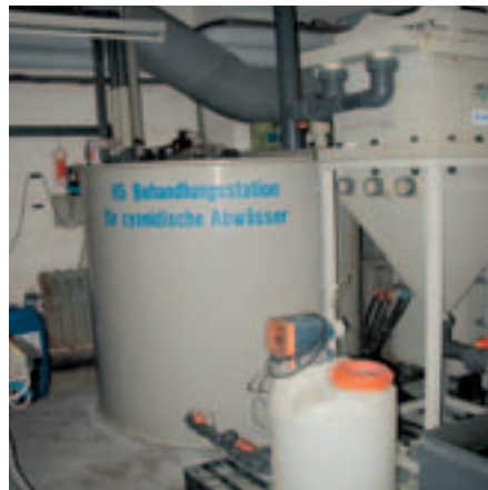
Bild 6-2: Abwasserbehandlungsanlage für cyanidische Abwässer
